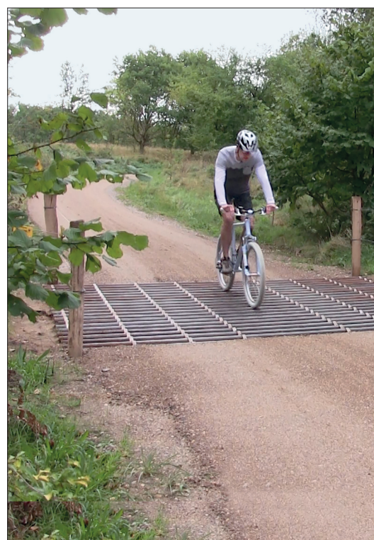
Færisten her er med galvaniserede rør
